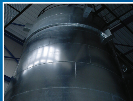
Термомасляный котел 7 МВт Теплостанция СЕВЕР Тржебич
